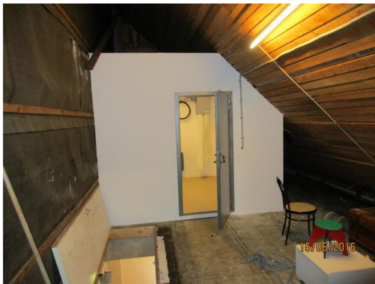
Figur 18 – Nyindrettet teknikrum etableret i eksisterende bygning
