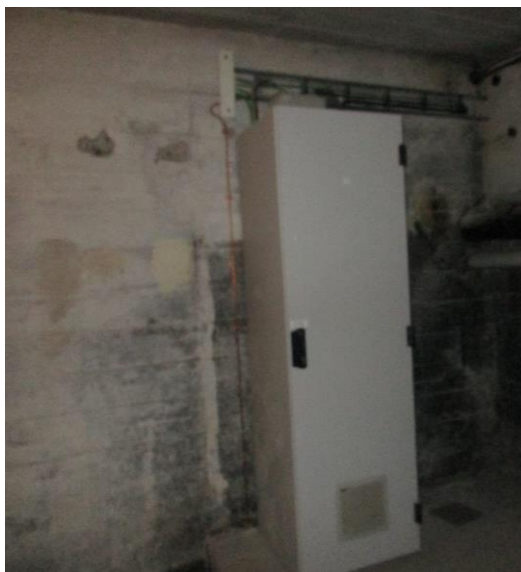
Figur 17 – Teknikskab placeret indeni bygning
