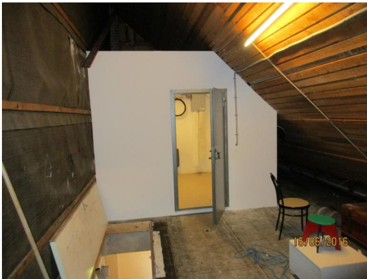
Figur 18 – Nyindrettet teknikrum etableret i eksisterende bygning
