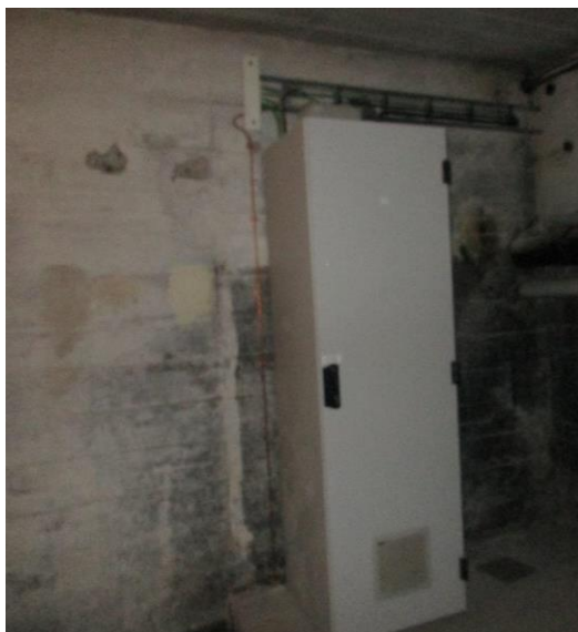
Figur 17 – Teknikskab placeret indeni bygning
