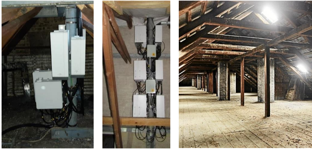
Figur 1 – Teleudstyr placeret i u-udnyttet tagrum / teknik-tagrum
