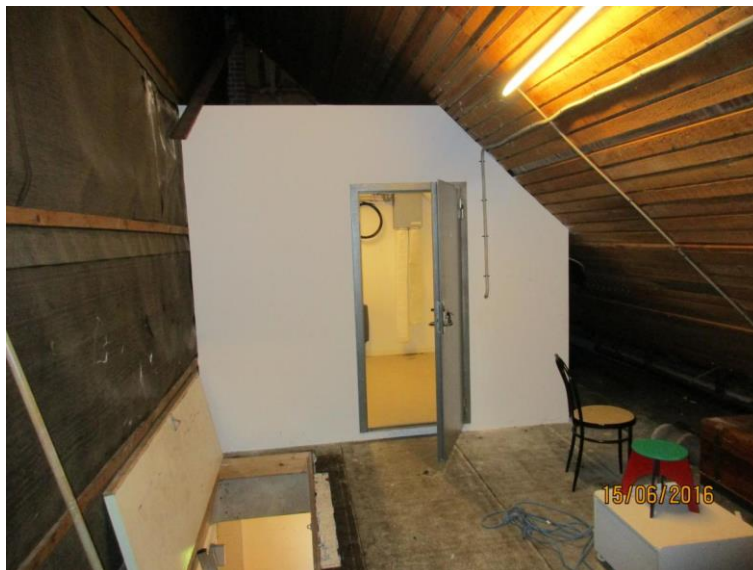
Figur 18 – Nyindrettet teknikrum etableret i eksisterende bygning
