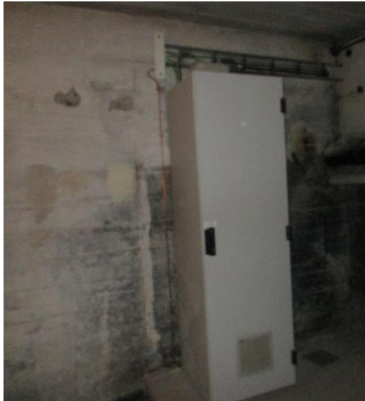
Figur 17 – Teknikskab placeret indeni bygning
