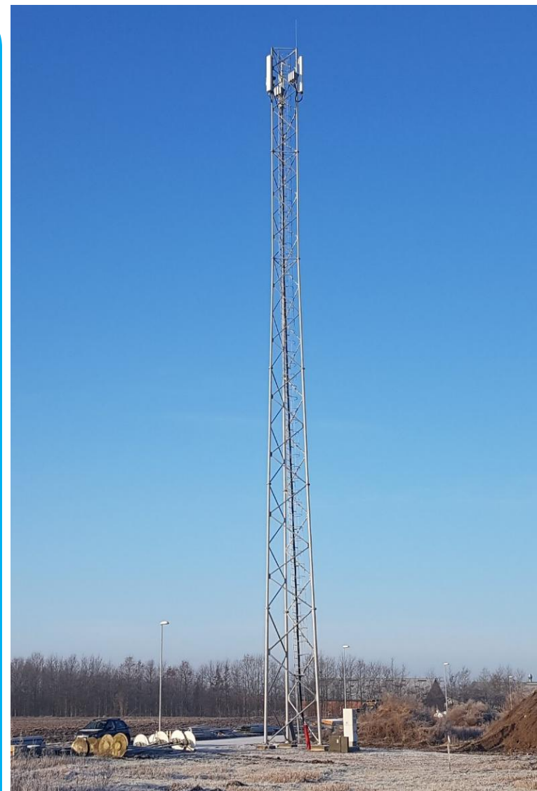
KK1 + CC1 Selvbærende gittermaster der ved svigt IKKE kan kollideres med bebyggelse eller større færdselsårer/ befærdede områder.
