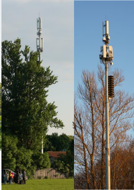
Rørmast før og efter opgradering til 5G. Side-by-side efter opgradering
