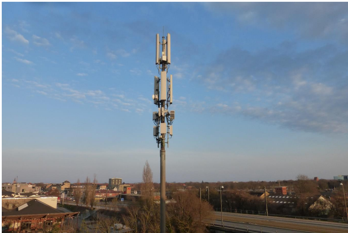
Foto af konstruktion med antenner set fra øverste svalegang
