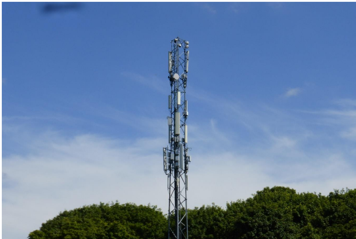
Antenner på mast (ubelastet)
