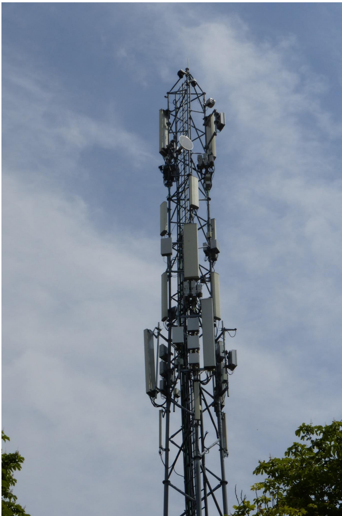
Antenner på mast (ubelastet)
