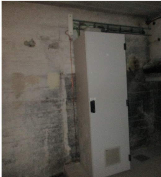
Figur 17 – Teknikskab placeret indeni bygning
