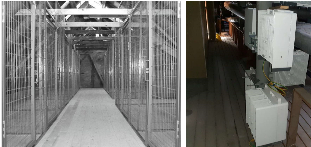
Figur 21 – Teknisk udstyr/radiotekniske komponenter placerede i udnyttet tagrum, tagrum med depotrum eller pulterrum
