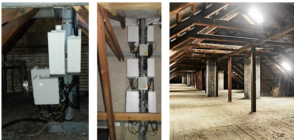
Figur 20 – Teknisk udstyr/radiotekniske komponenter placerede i u-udnyttet tagrum / teknik-tagrum
