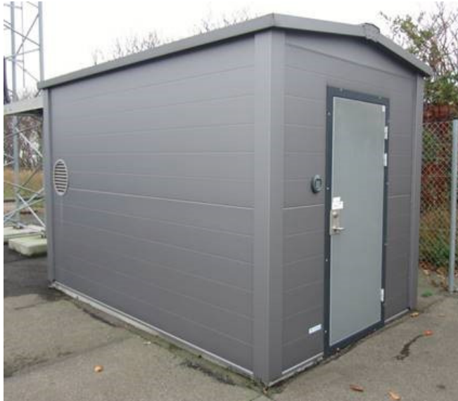
Figur 22 – Teknikkabine til udendørs brug
