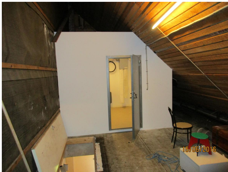
Figur 18 – Nyindrettet teknikrum etableret i eksisterende bygning
