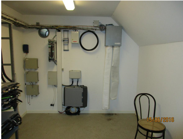
Figur 19 – Teknisk udstyr placeret i eksisterende teknikrum
