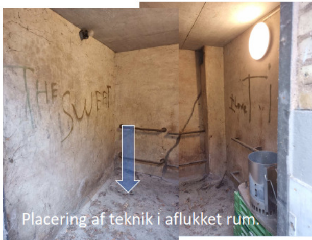
Figur 6 – Aflukket rum, hvor væggene udført af beton. Pilen indikerer placering af teknik.
