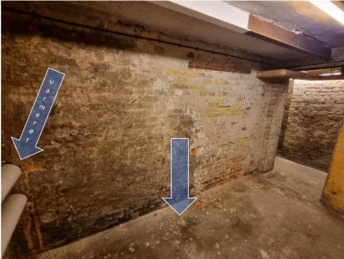
Figur 7 – Varmt kælderrum med eksisterende varmerør, hvor væggene er udført som teglvæg. Pilen indikerer placering af teknisk udstyr.
