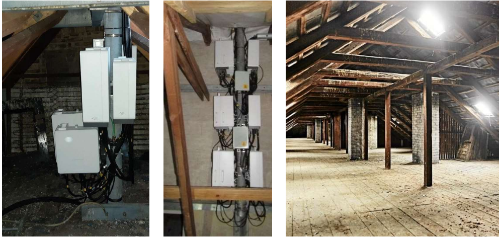
Figur 4 – Teknisk udstyr/radiotekniske komponenter placerede i u-udnyttet tagrum / teknik-tagrum
