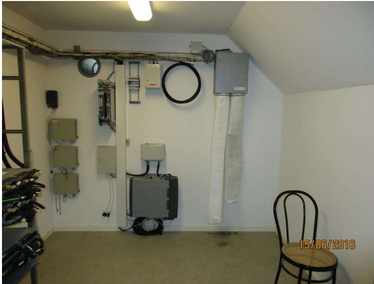
Figur 3 – Teknisk udstyr placeret i eksisterende teknikrum
