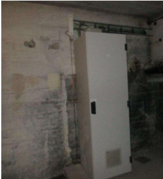
Figur 1 – Teknikskab placeret indeni bygning
