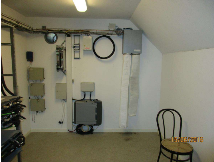
Figur 1 – Teknisk udstyr placeret i eksisterende teknikrum
