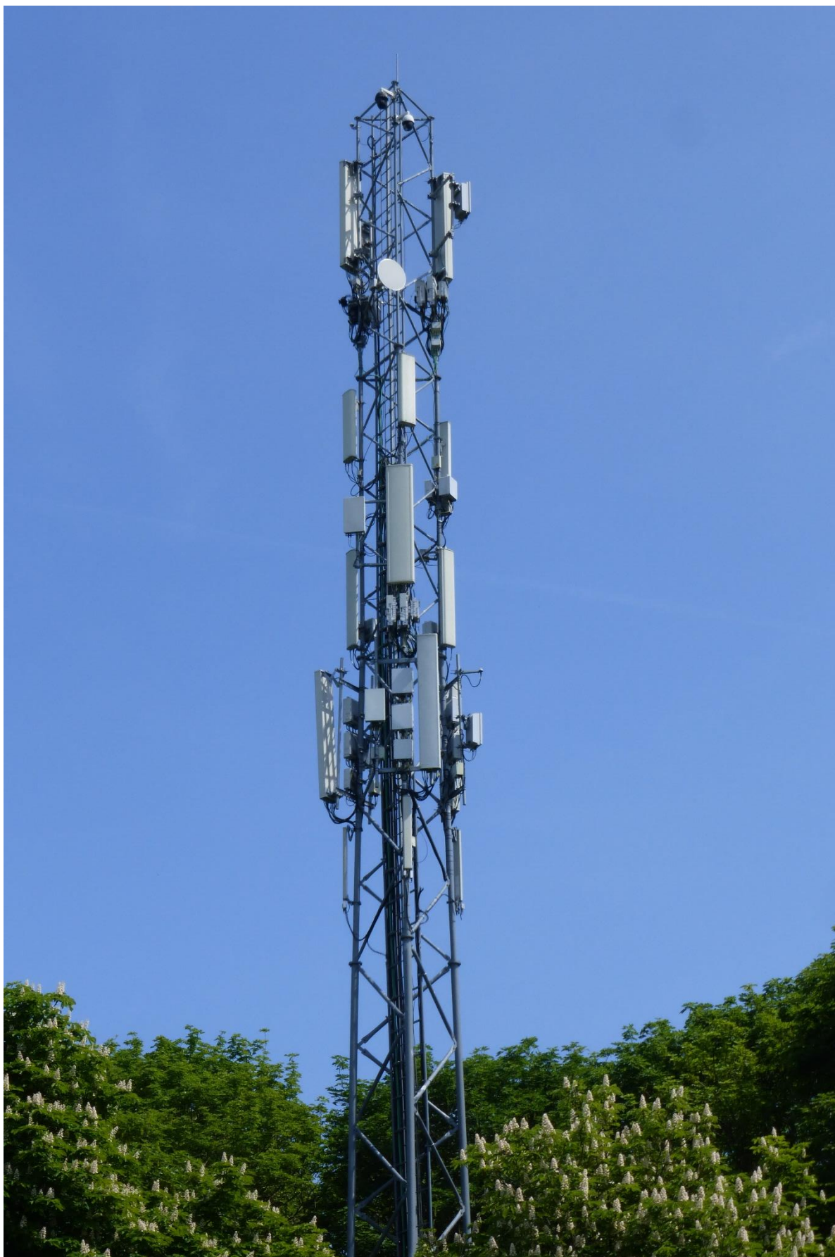
Antenner på mast (ubelastet)
