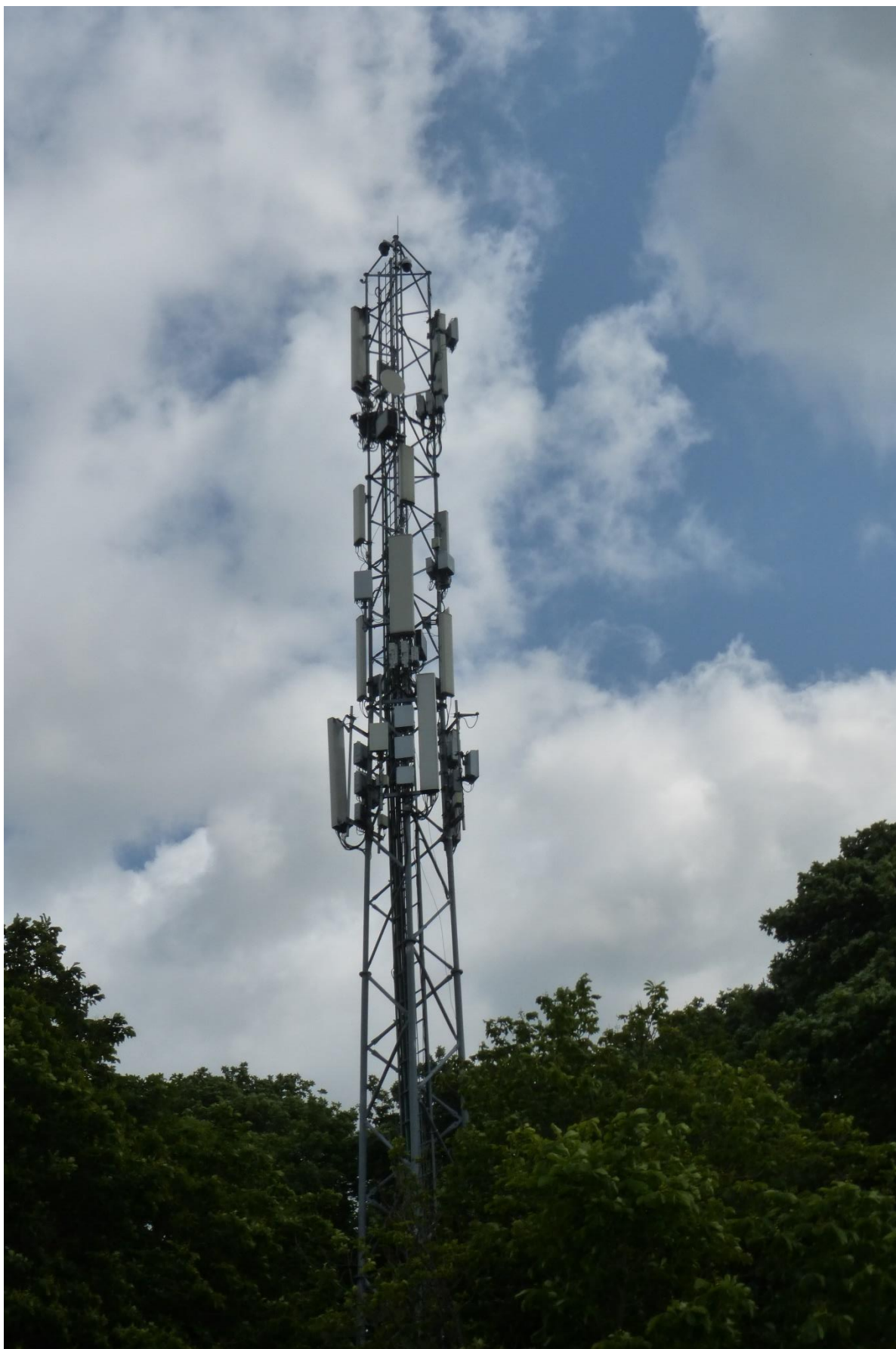
Antenner på mast (ubelastet)
