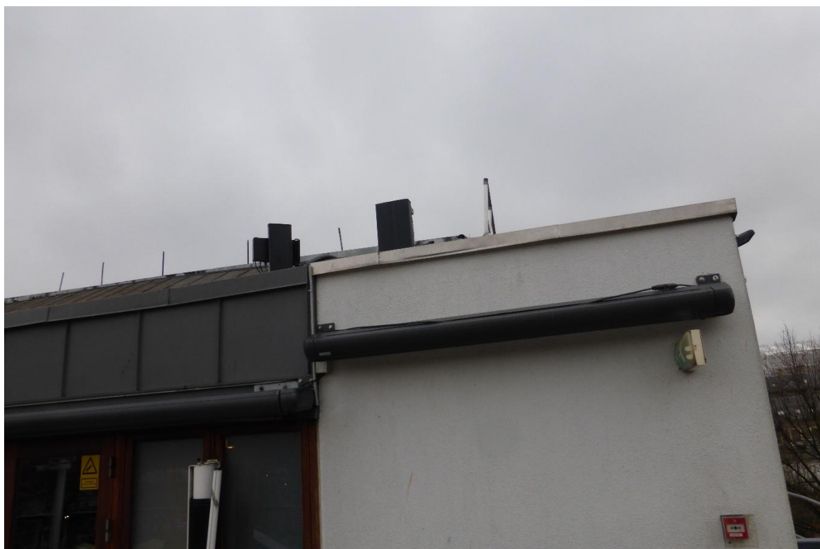
Udsigt til antenner fra målepunkt 11
