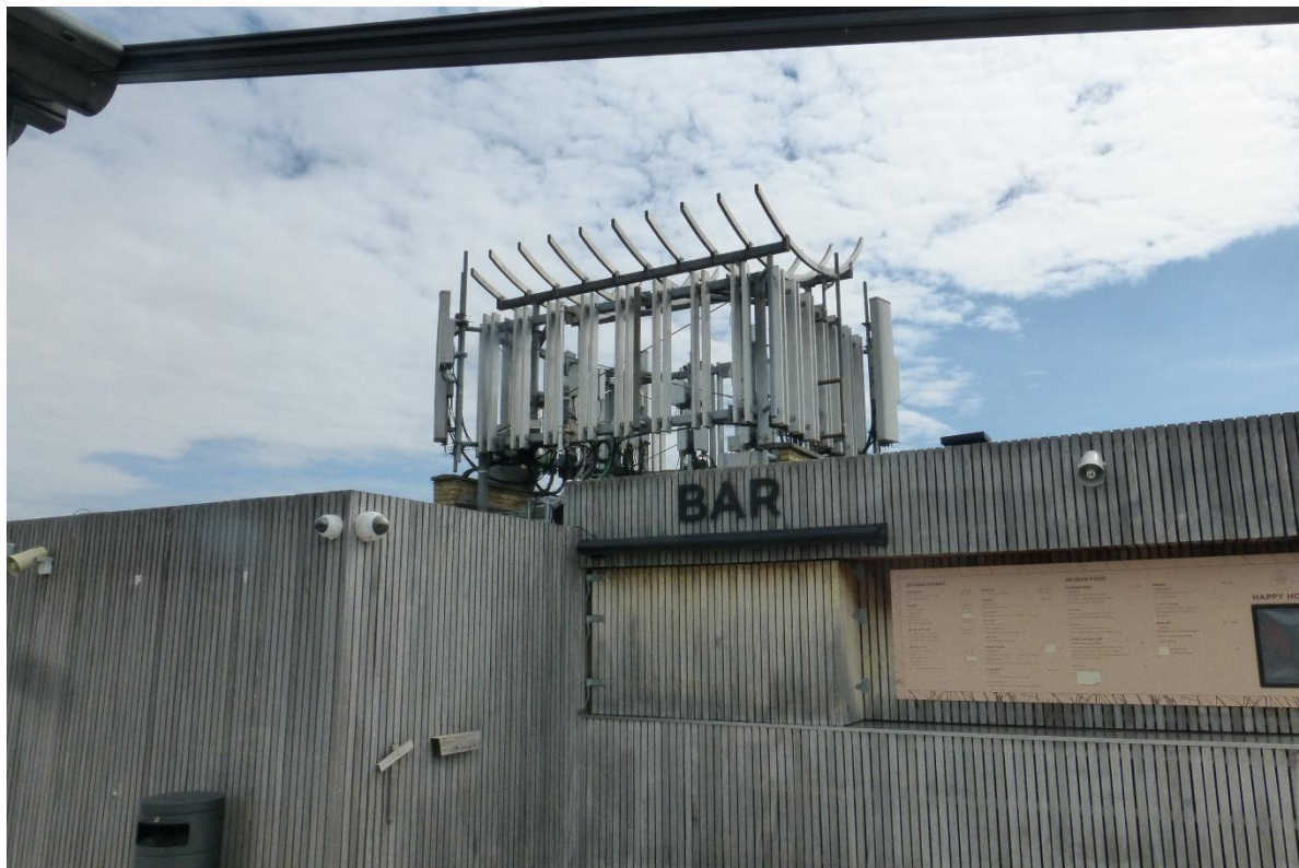
Mobilantenner på taget
